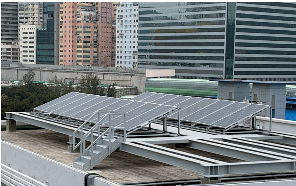
香港仔的警察學院教學大樓天台裝設光伏板。
