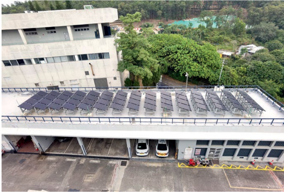
边界警区总部停车场上方架设光伏板，收集太阳能。
