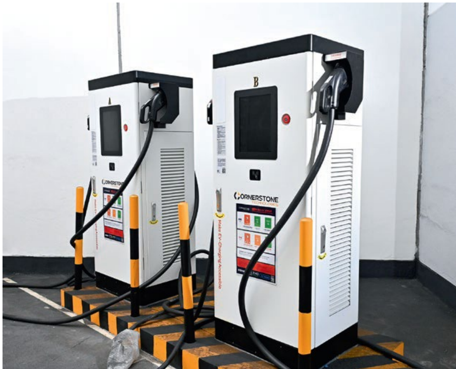
警察总部大楼内的电动车充电站。
