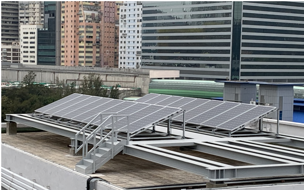
香港仔的警察学院教学大楼天台装设光伏板。
