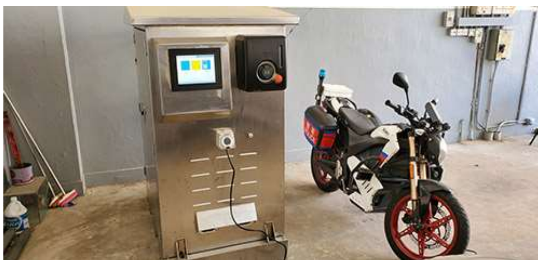
警察駕駛及交通訓練中心設有電池儲能電動車充電站。
