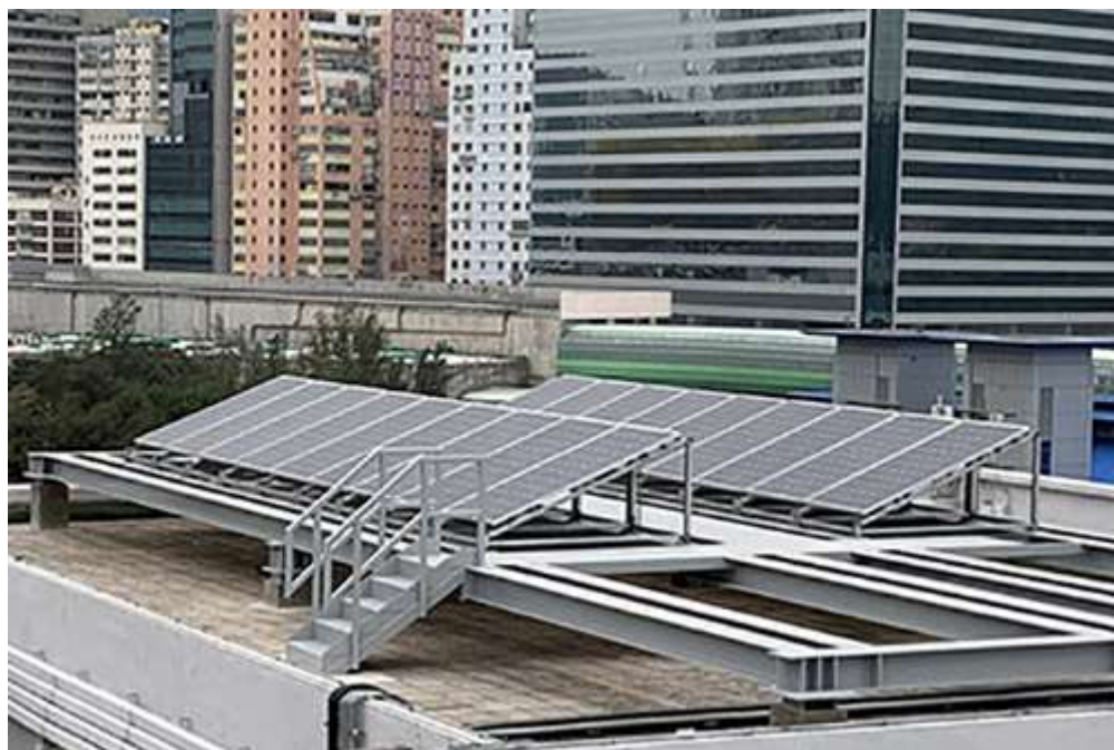
香港仔的警察學院教學大樓天台裝設光伏板。
